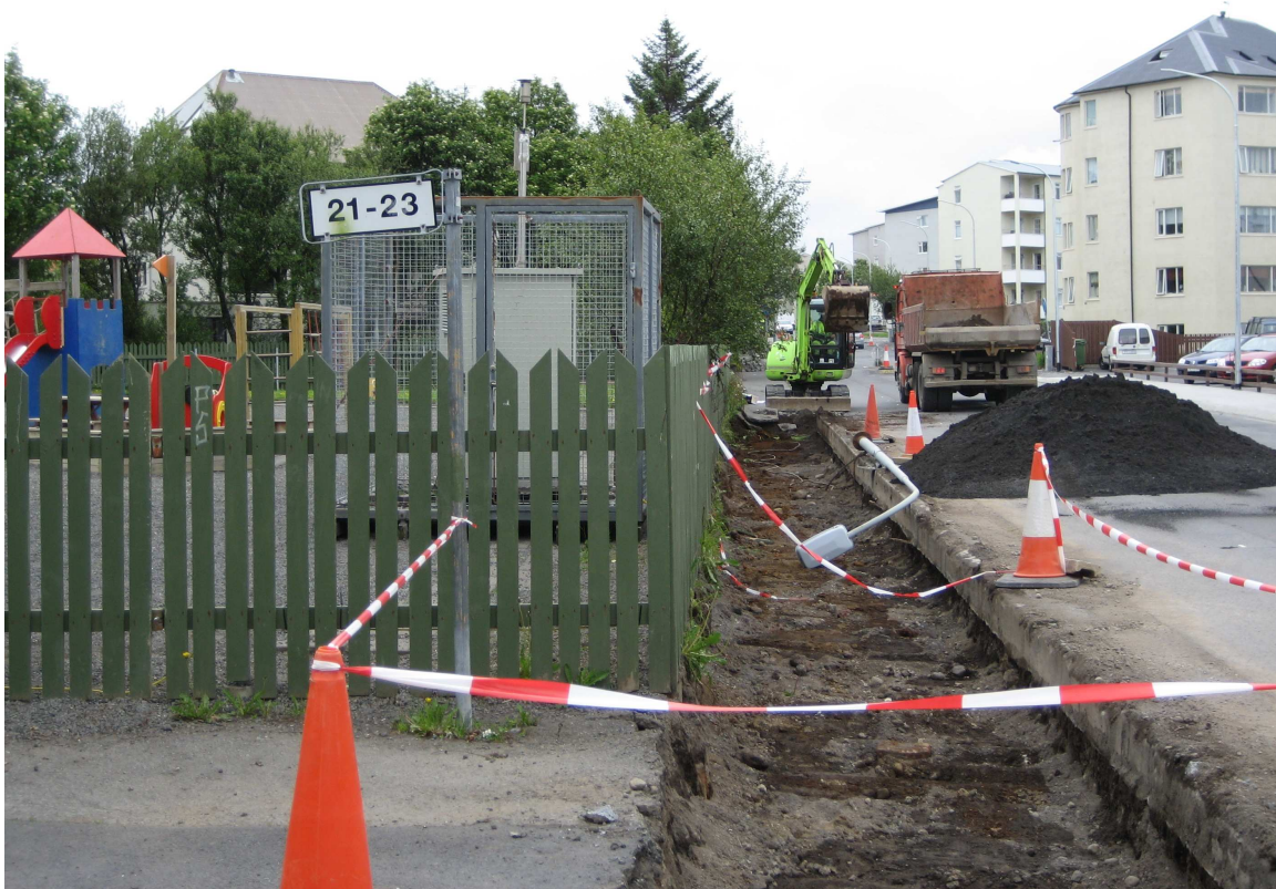
Mynd 2. Farstöðin staðsett við Leikskólann Hlíðaborg. Á myndinni má einnig sjá framkvæmdasvæði Orkuveitu Reykjavíkurborgar í Eskihlíð þar sem verið var að leggja ljósleiðara beint fyrir framan leikskólann.
